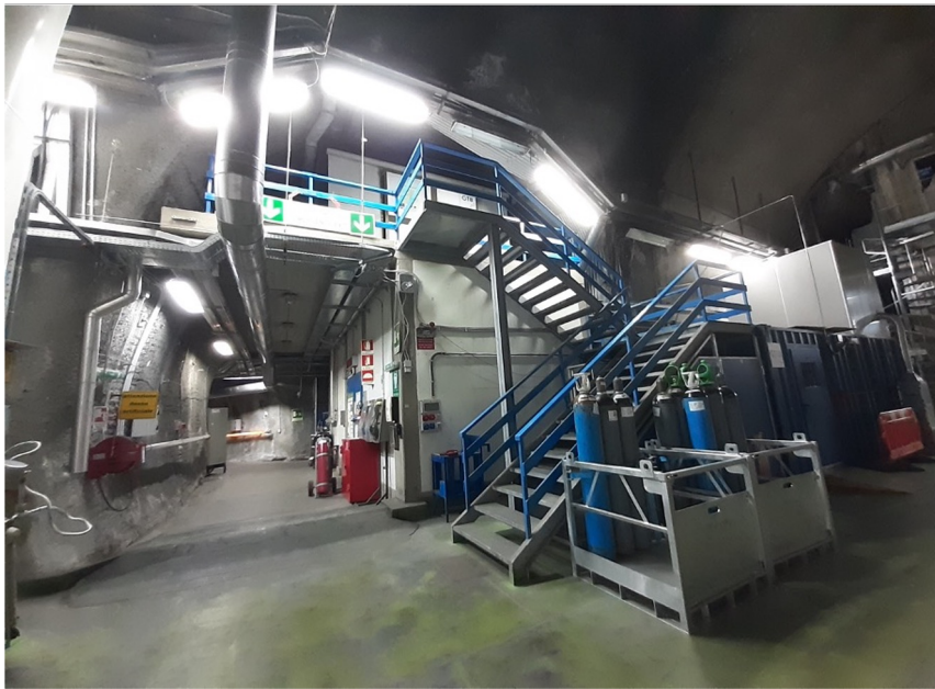
SABRE North area @ LNGS
